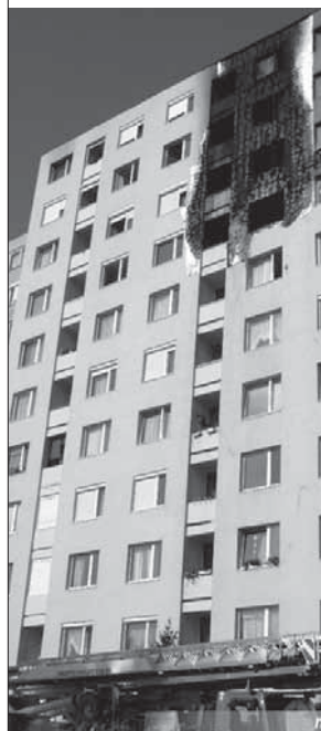
Fasáda paneláku v Miskolci po požiari.
